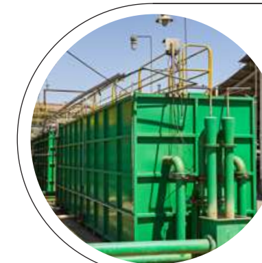
Após o uso, a água segue para a Estação de Tratamento de Efluentes (ETE) e retorna para o seu novo ciclo.
